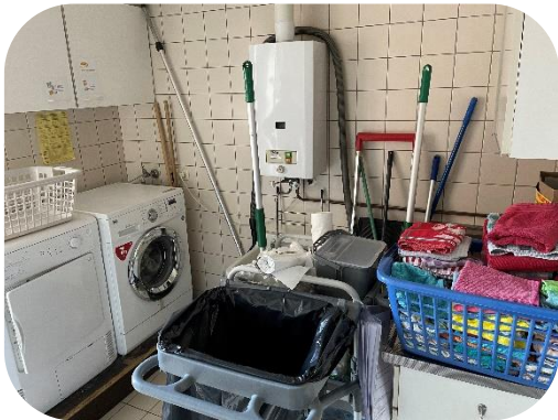
Gecombineerde was-/schoonmaakruimte met geiser t.b.v. warm water
