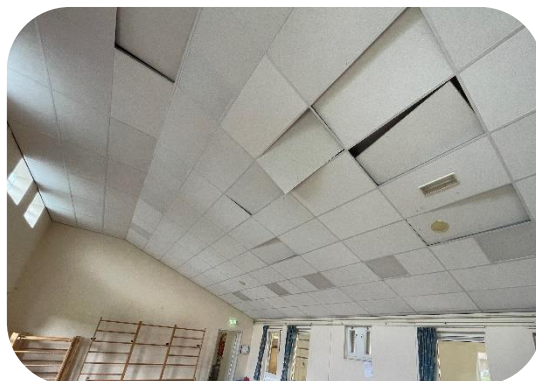
Balvastheid plafond speelzaal onvoldoende
