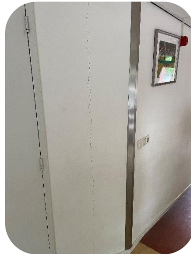
Scheurvorming op aansluiting bouwdelen 1948 en 1991
