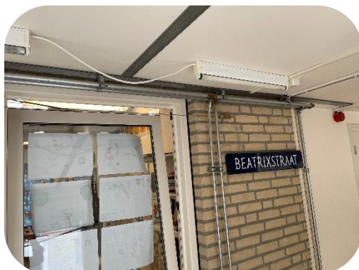
Installaties in het zicht, aangebouwde gang bouwdeel 1991
