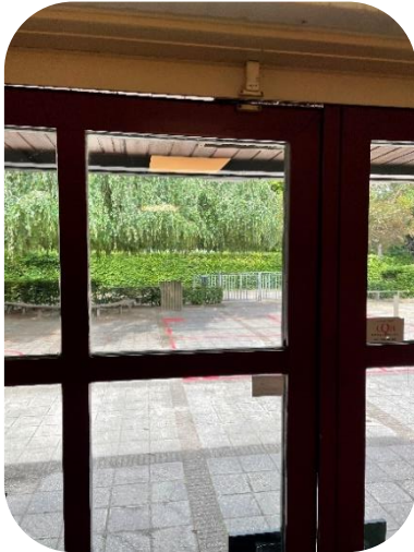
De deuren sluiten slecht en hebben ook na het sluiten zichtbare kieren
