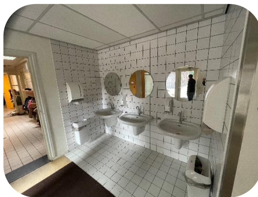
Toiletruimte wordt gebruikt als verkeersruimte naar bouwdeel 1991
